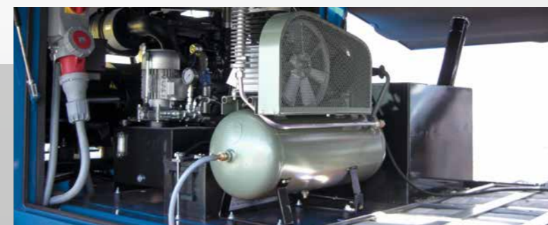
Compresseur pour le nettoyage
